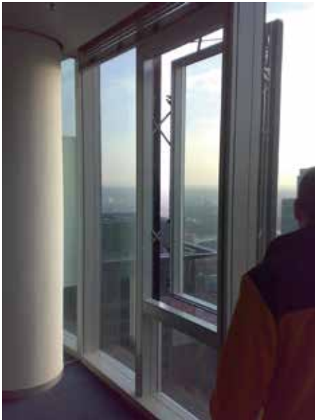
Parallelausstellfenster [PAF] geöffnet, Innenansicht
